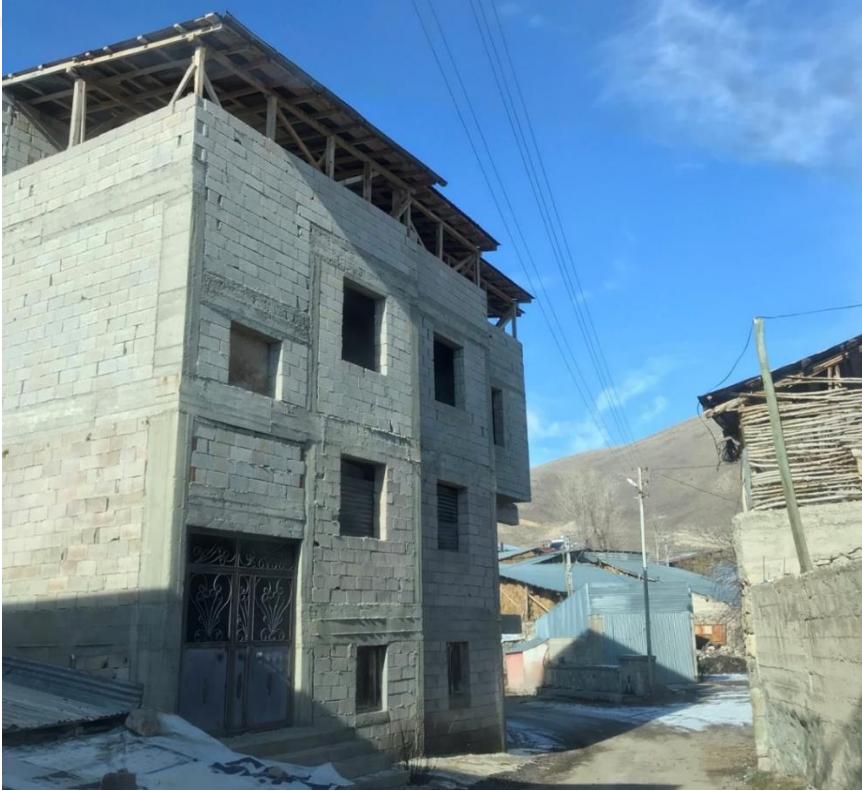
Şekil 3.13 Köy içerisinde tamamlanmayan apartman tipi yapı örneği (Yazar arşivi, 2025)
